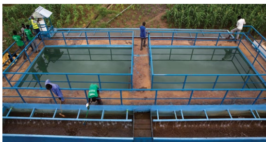
Varios empleados trabajan en la planta de tratamiento de agua de Bentiu, en Sudán del Sur.
