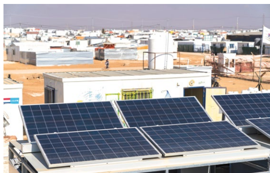
Paneles solares, campo de Za'atari, Jordania.
